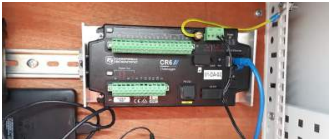
Figuur 22: foto van de CR6 datalogger in de beschermingskast
