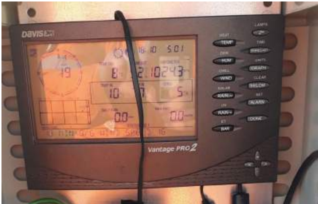
Figuur 23: foto van de gemonteerde datalogger van het weerstation
