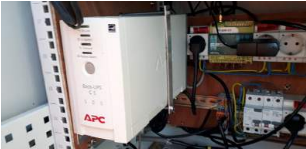
Figuur 19: foto van een gemonteerde UPS in een beschermingskast
