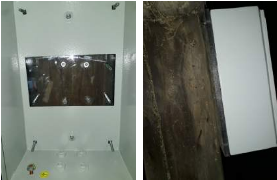
Figuur 40: Afbeelding bevestiging Tiltmeter en beschermkast op houten gebint
