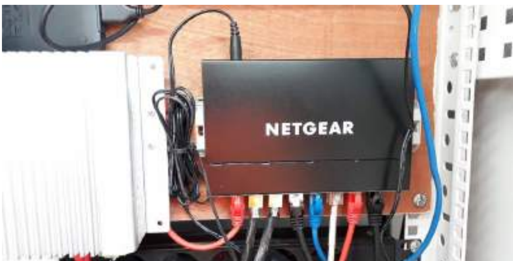
Figuur 20: Foto van gemonteerde GS308E in een beschermingskast
