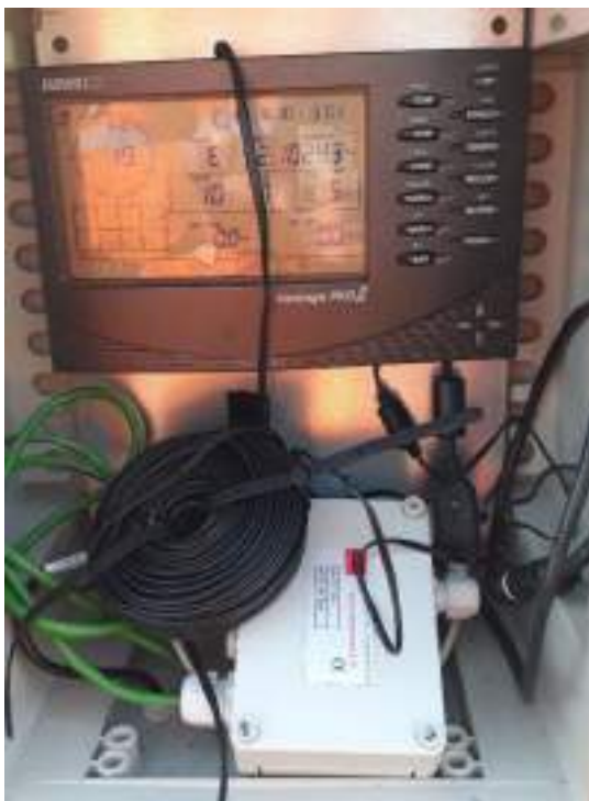
Figuur 42: Plaatsing Vantage Pro 2 datalogger in meetkast
