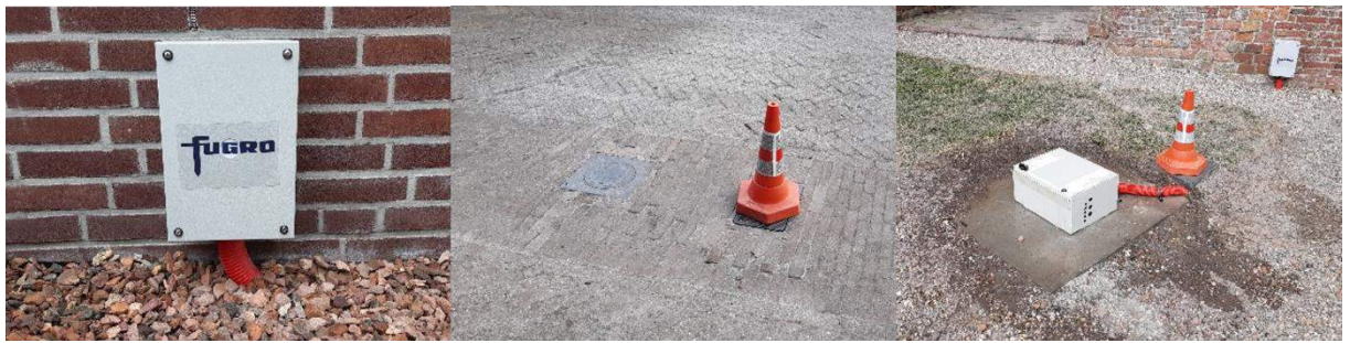
Figuur 4.2: Typische meetopstelling voor de tilsensoren op gevels (links), LILY-sensoren in de ondergrond (midden) en dynamische tilsensor/accelerometer op de meetplaat (rechts).
